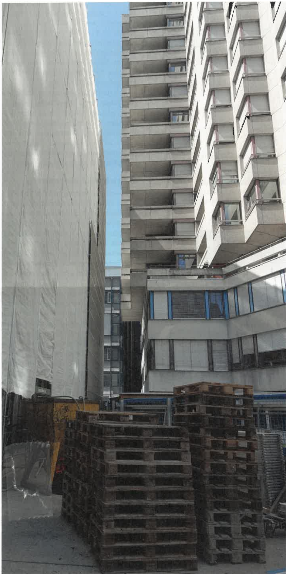
Das Gebäude im «Baubereich 12» muss im engen Perimeter erstellt werden. (Bild: links der Neubau, rechts das alte Gebäude.)
